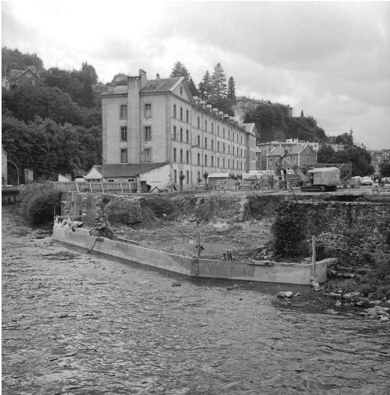
Travaux de fondations de la future cité administrative (29 mai 1971 - archives départementales de la Corrèze - 23fi/33556)
